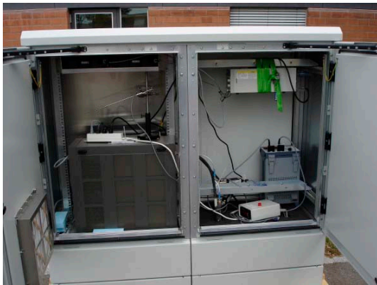
Fig. 2 Blick in den geöffneten Verstärkerkasten
